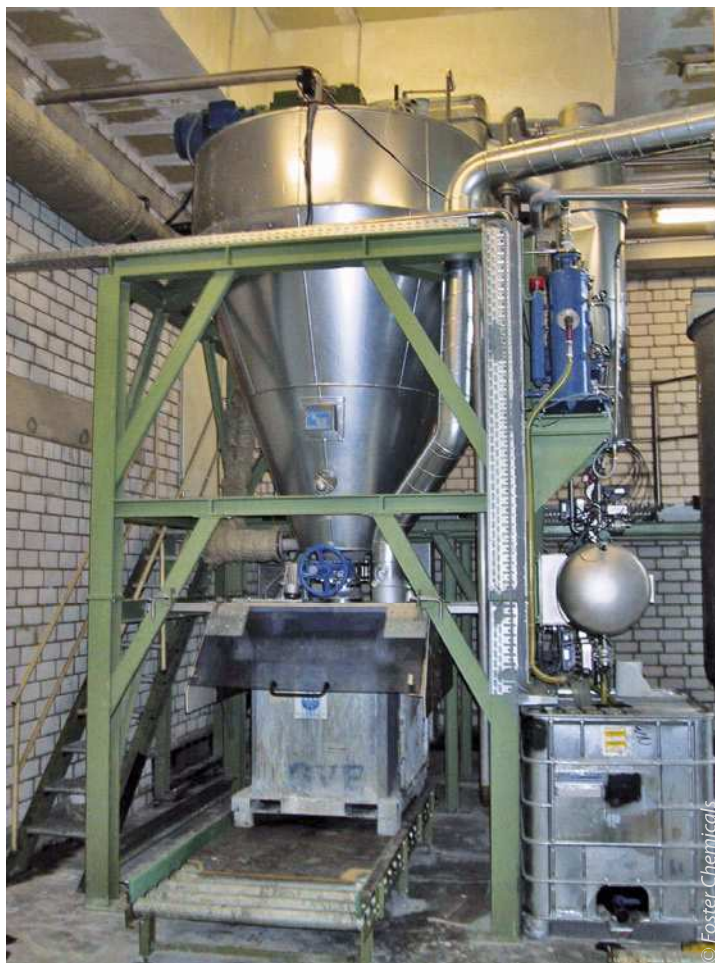
Auch die neuen NMP-freien beziehungsweise NMP-reduzierten Entlacker sind destillierbar und werden vom Chemikalienlieferanten zurückgenommen. Für die Destillation steht eine leistungsfähige Anlage zur Verfügung.
